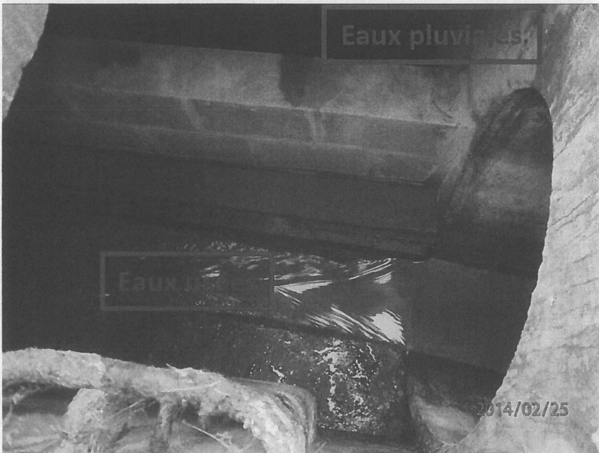
Figure 2. Intérieur de notre déversoir d'orage avec les sections dédiées aux différents types d'eaux © INASEP
